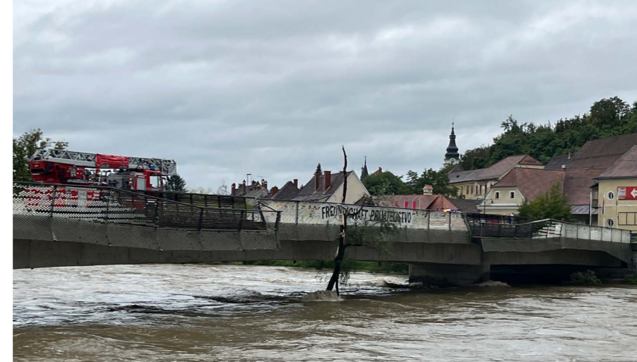
Auch das Hochwasser machte vor dem Gemeindegebiet der Stadtgemeinde nicht halt und verursachte gravierende Schäden. Um weitere Schäden zu vermeiden, mussten Verkläusungen gelöst werden, wie dies hier bei der Murbrücke ersichtlich ist.
