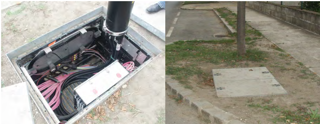
Abbildung 44: Straßenschacht bestückt für 72 Mikrorohre mit Betondeckel
