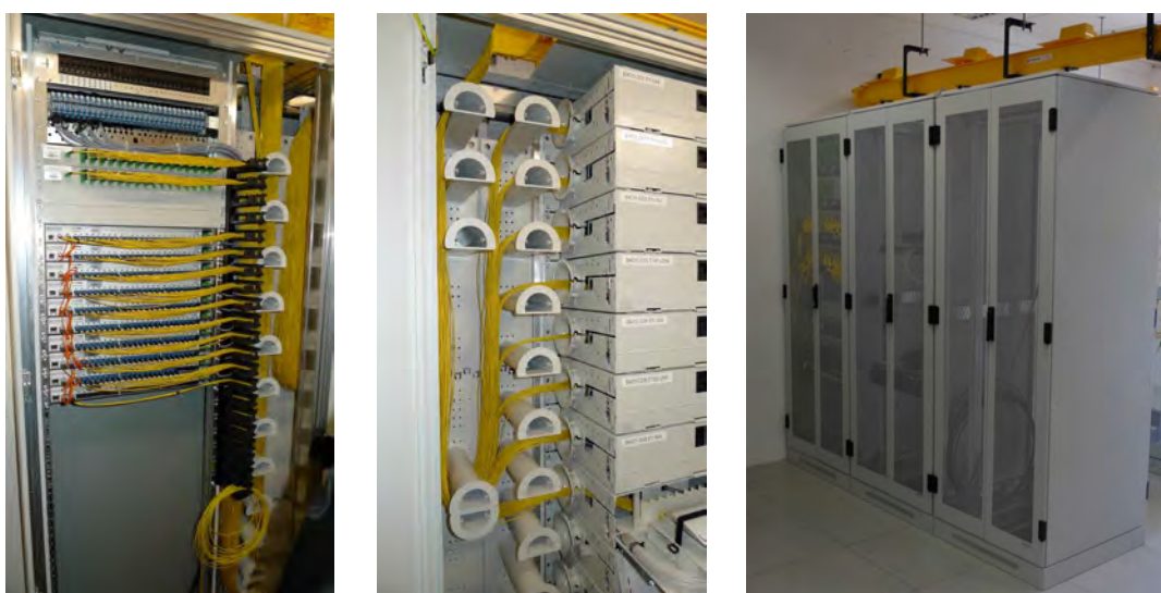
Abbildung 43: Aktive Komponenten, Fasermanagement und 19"-Schränke in einer Ortszentrale
